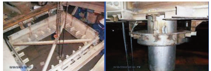
CAJA DE VISITA Y DUCTO DE ALIMENTACION
